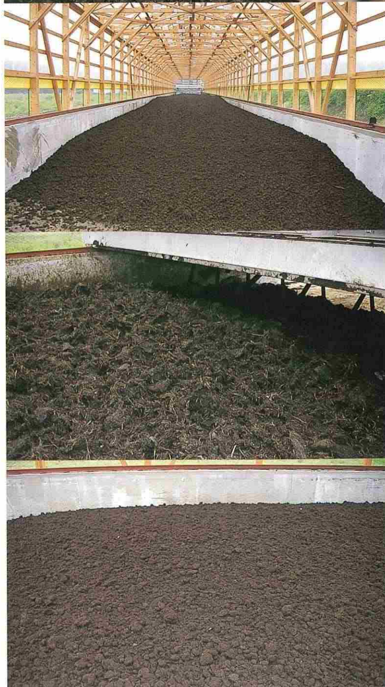
出口から見た発酵槽の全景
